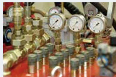
压力表和测压线
